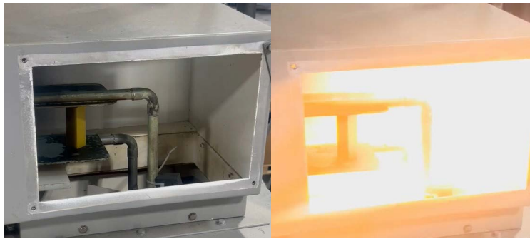
Figure 5. Before and after of an arc at the transmission line Figura 5. Antes y durante un arco eléctrico dentro de la línea de transmisión
