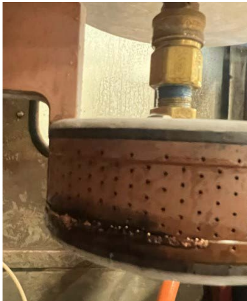
Figure 7. Coil damage Figura 7. Daño en una bobina de inducción
