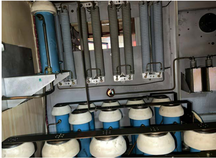
Figure 3. Capacitors Figura 3. Capacitores
